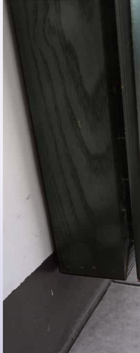
木框與底板損壞
