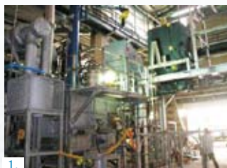
1.環資中心資源回收廠電漿設備 2.環資中心空氣污染防治設備 3.環資中心資源回收廠物化設備
