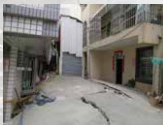
圖四、土壤液化造成建物沉陷災情。
